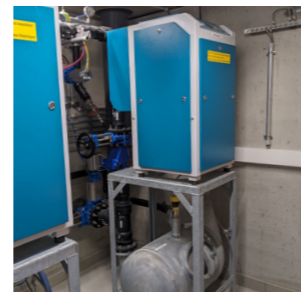
Anlagenraum mit Kompressoren
