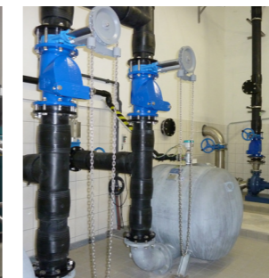
GULLICOMB® mit Freistromradpumpe
