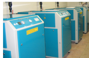
Kompressoren im Betriebsraum
