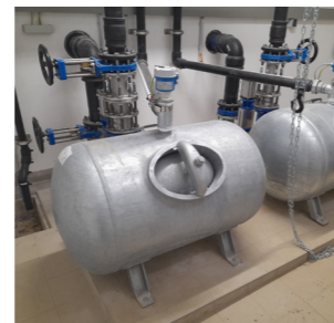
Arbeitsbehälter mit Verrohrung
