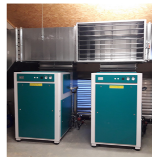
Kompressor mit Abluftsystem
