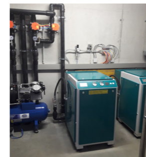
Kompressor mit Prozessluftführung
