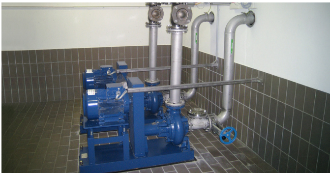
Trocken aufgestellte Pumpen
