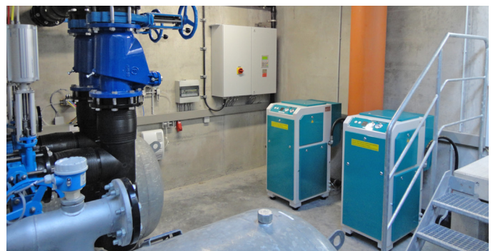
Anlagenraum mit Kompressoren
