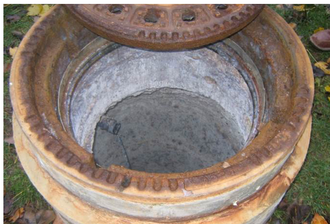
Durch Schwefelsäure-Korrosion angegriffener Betonschacht
