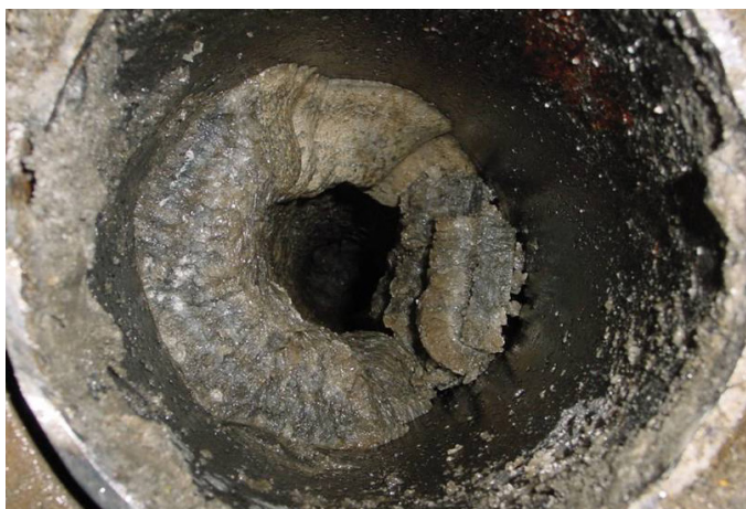
Sielhautbildung in der Rohrleitung
