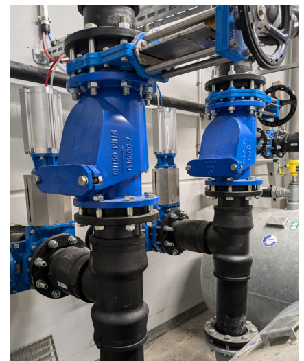
Armaturensatz mit Behälterverrohrung
