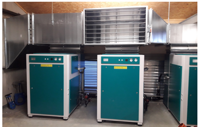
Kompressor mit Abluftsystem
