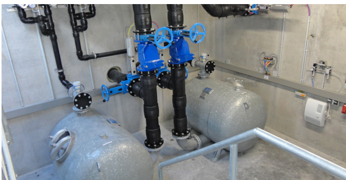
Arbeitsbehälter mit Verrohrung
