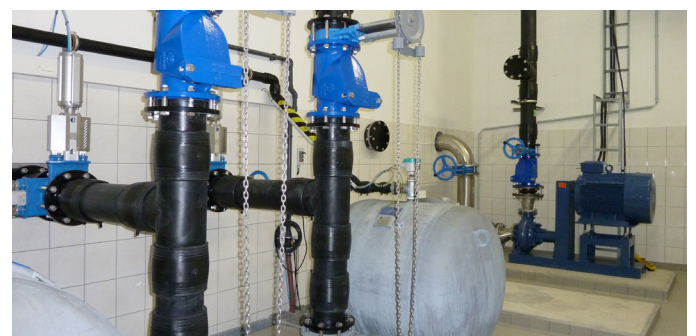
GULLICOMB® mit Einkanalaradpumpe
