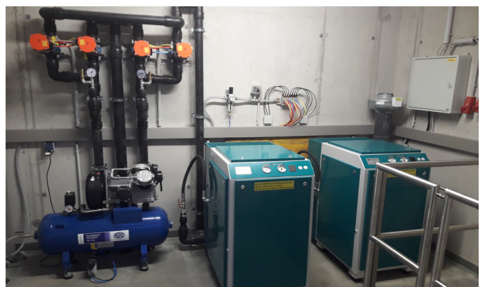
Kompressor mit Prozessluftführung
