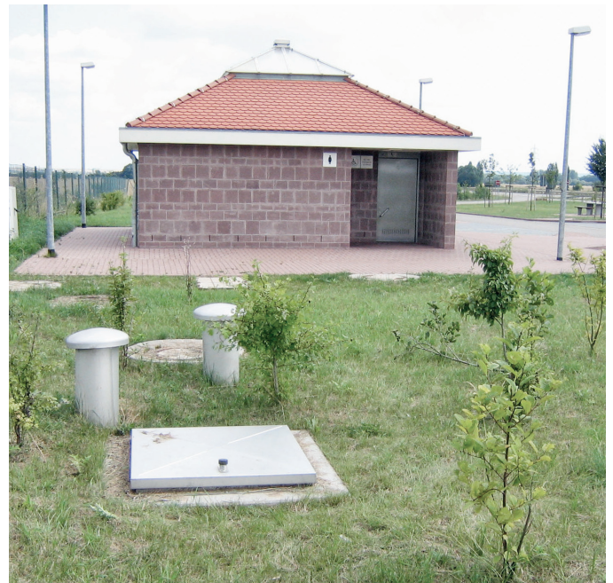
System GULLIVER® an einer Autobahnraststätte
